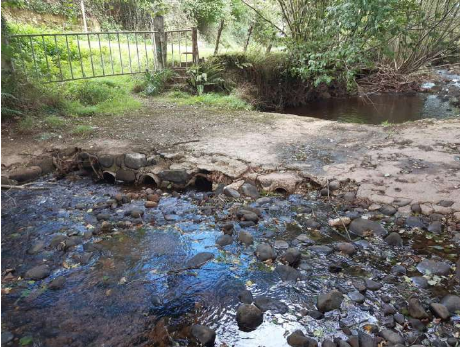
Previo a la actuación se observa el detalle de la estructura de hormigón en desuso
