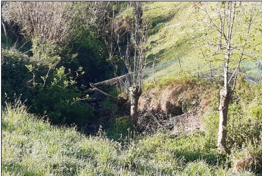
Previo a la actuación: restos vegetales depositados en el lecho del cauce
