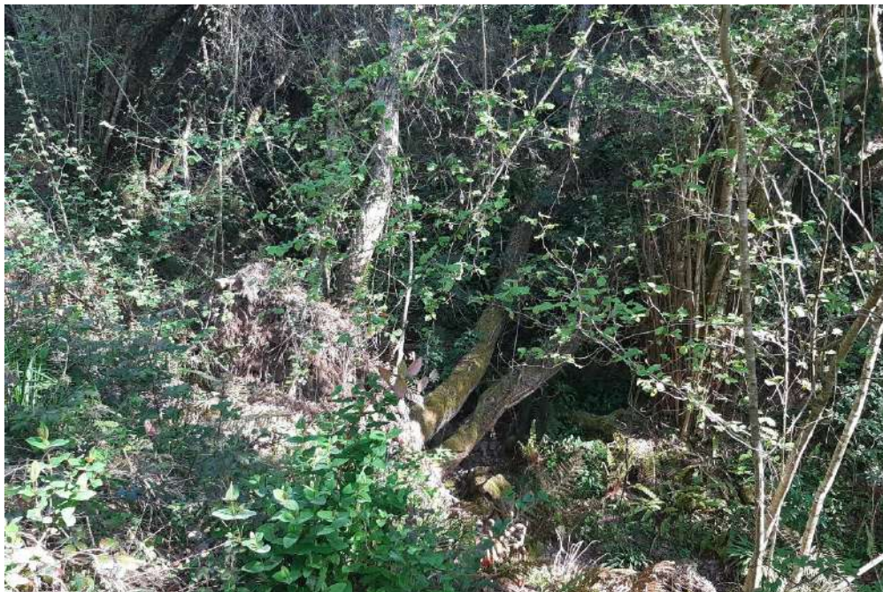
Previo a la actuación: restos vegetales depositados ocasionando tapones
